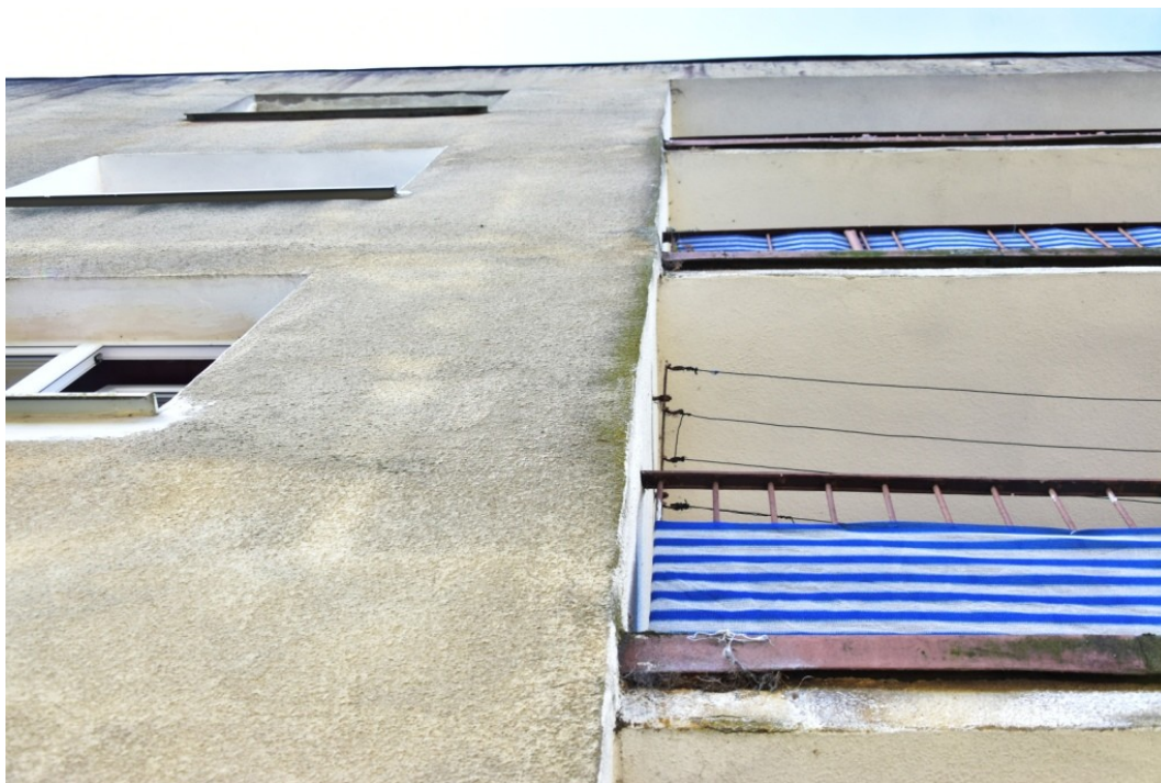
Fot.11. Miejsce gniazdowania wróbla w szczelinach pod balkonami (aut. Szymon Wójcik).
