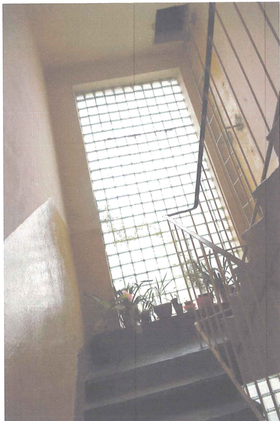
Naświetla od strony wewnętrznej.
