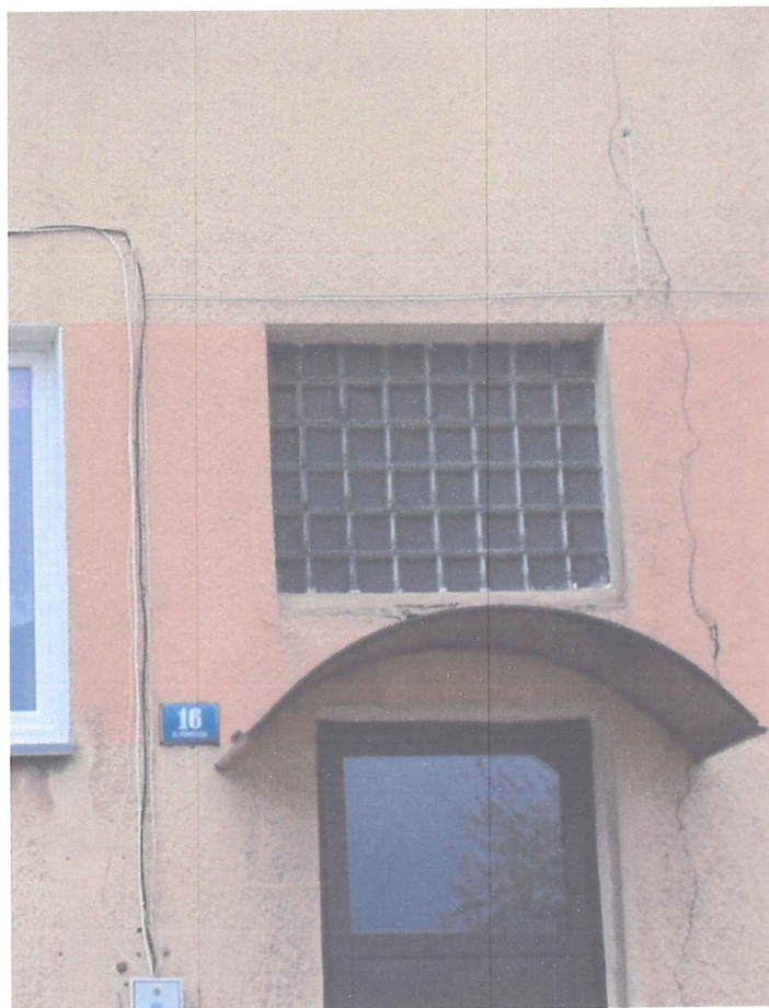
Luksfery nad wejściem i pęknięcie ściany
