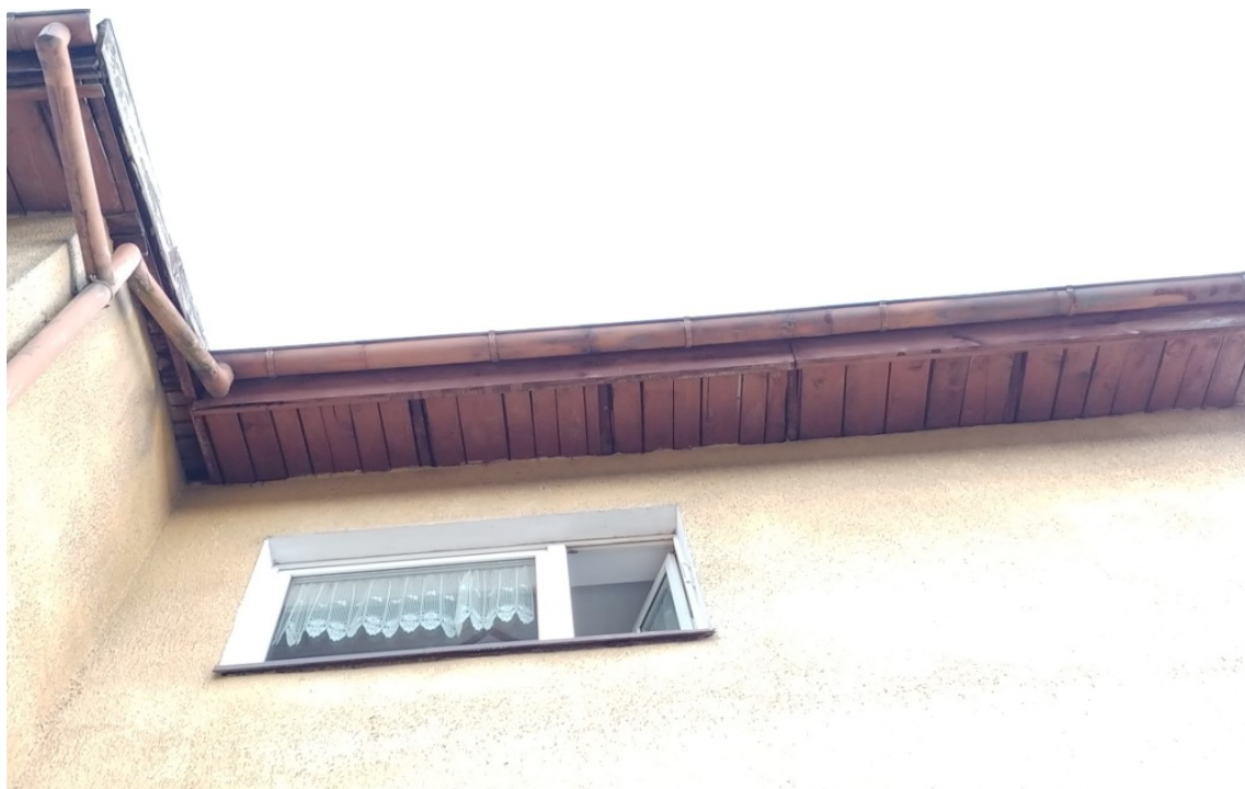
Fot.6. Część stropowa z ubytkami; miejsce gniazdowania jerzyka (aut. Szymon Wójcik).
