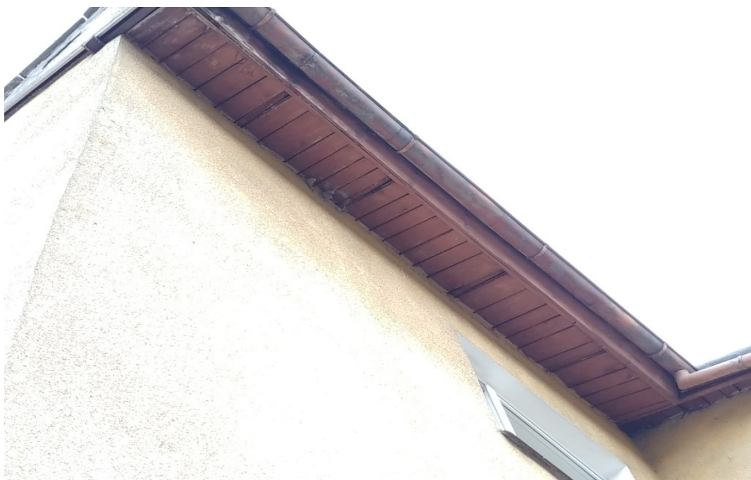
Fot.4. Część stropowa z ubytkami; miejsce gniazdowania jerzyka (aut. Szymon Wójcik).
