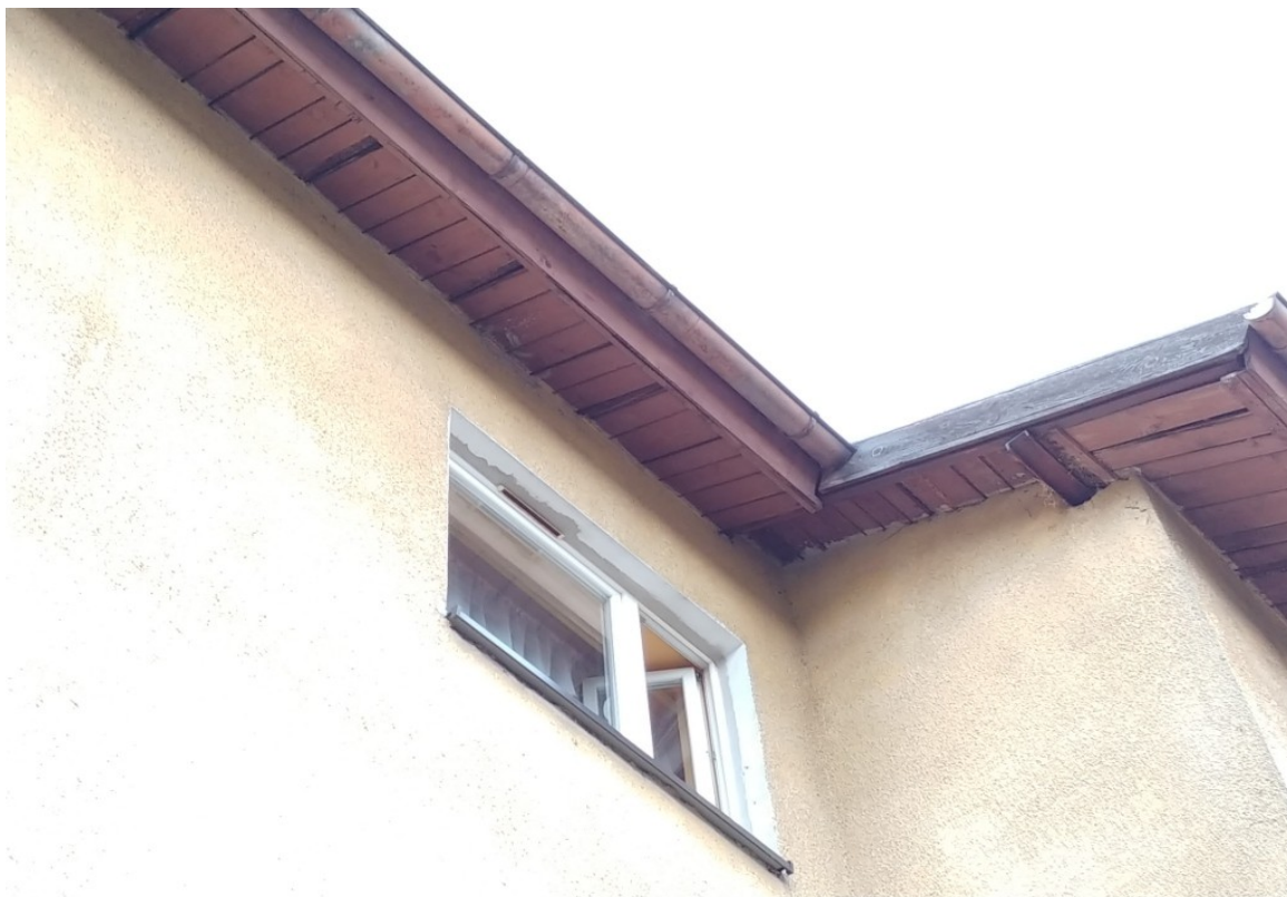
Fot.5. Część stropowa z ubytkami; miejsce gniazdowania jerzyka (aut. Szymon Wójcik).
